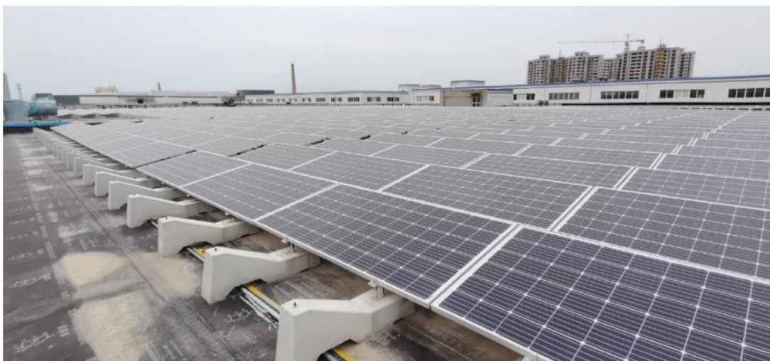
恒安集团iBlock平屋顶工商业光伏项目
