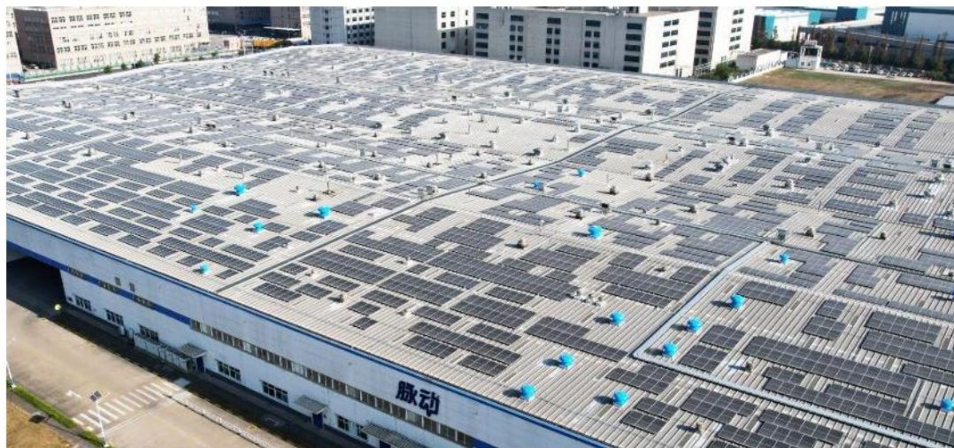
达能中国脉动工厂4.3MW工商业光伏电站项目
